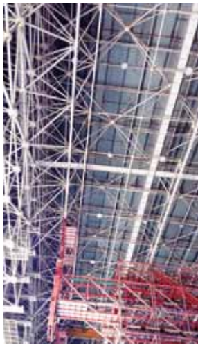
廈門太古機庫的天花燈實施燈控管制。
